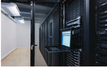
Altyapı sistemleri odası
