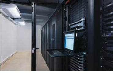
Altyapı sistemleri odası
