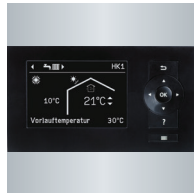
Isı pompası kontrol paneli Vitotronic 200
